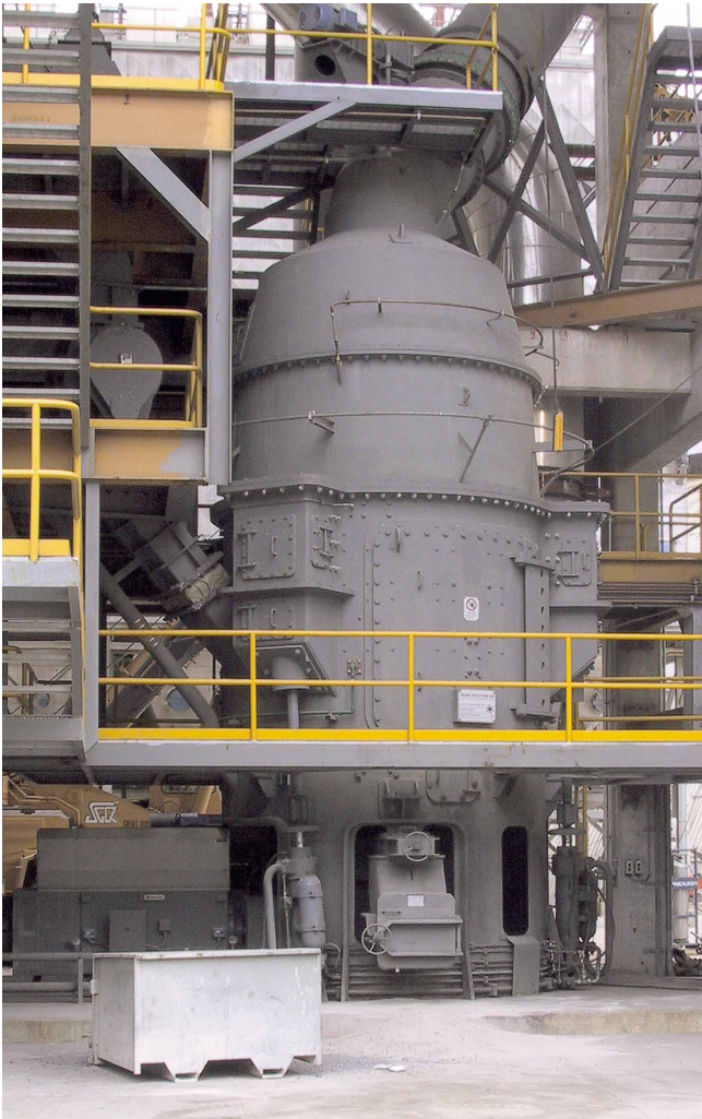
4 Kohlemühle MPS 250 BK bei La Cemento Nacional/Ecuador 4 MPS 250 BK coal grinding mill at La Cemento Nacional/Ecuador
